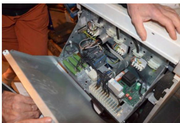
Electronique des PAC capot ouvert assurant le contrôle du débit du fluide caloporteur
