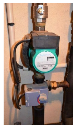
La valve 3 voies radiateurs 50°C
