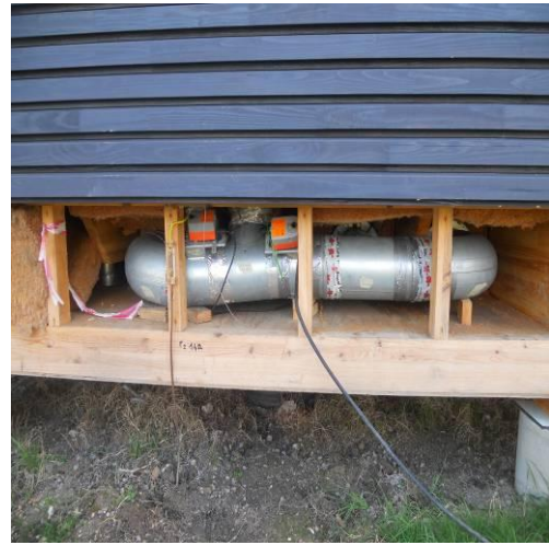
Figure 99 : vue de l'assemblage du circuit hydraulique amont
