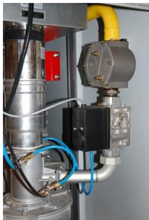
Figure montrant le variateur de vitesse sur l'arrivée d'air de combustion et de gaz naturel d'un brûleur de chaudière moderne (Courtesy de Dietrich).
