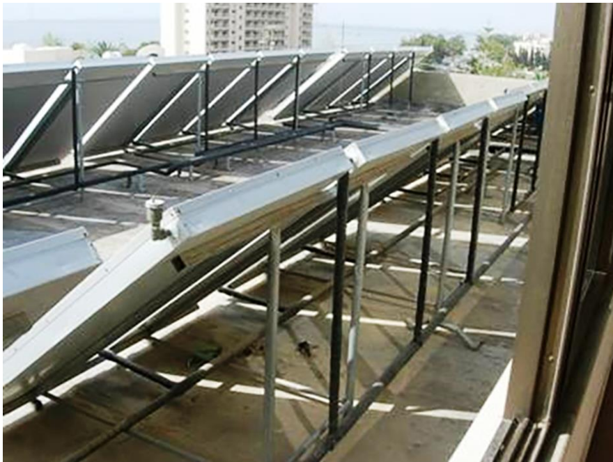
Exemple de cellules thermosolaires implantées dans le collectif en terrasse d'un immeuble en région méditerranéenne. On remarque les tuyauteries hydrauliques (purgeur).
